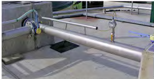
Die Gasleitungen bestehen aus Edelstahl.
