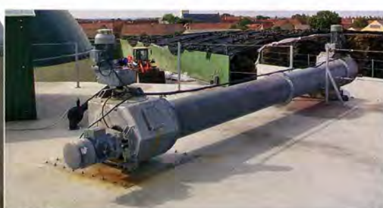
Das Rohr der verzinkten Förderschnecke für den Mais zeigt bereits Rostansatz.
